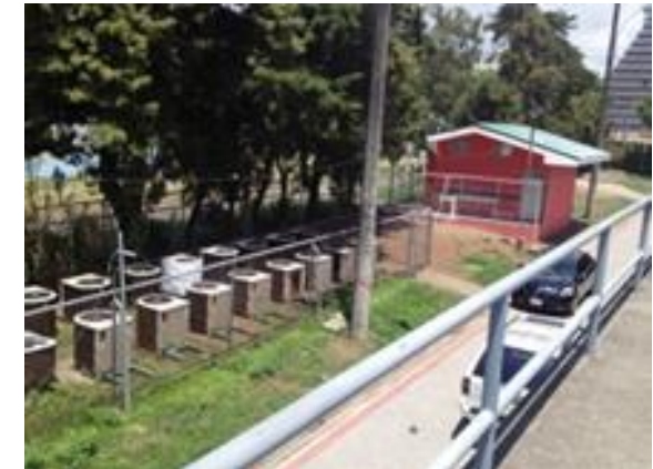
Imagen 73. Instalaciones mecánicas. Fuente: Propia
