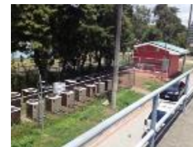
Imagen 63. Instalaciones mecánicas y eléctricas. Fuente: Propia
