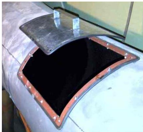
Figura 24. Registro en ducto de extracción
