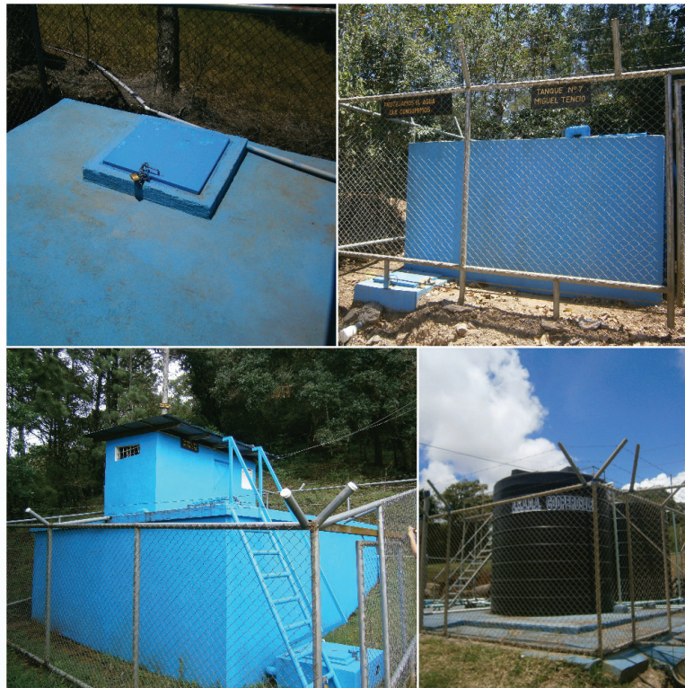
Figura 5.11. Diferentes tanques presentes en los acueductos evaluados Cantón Central.
