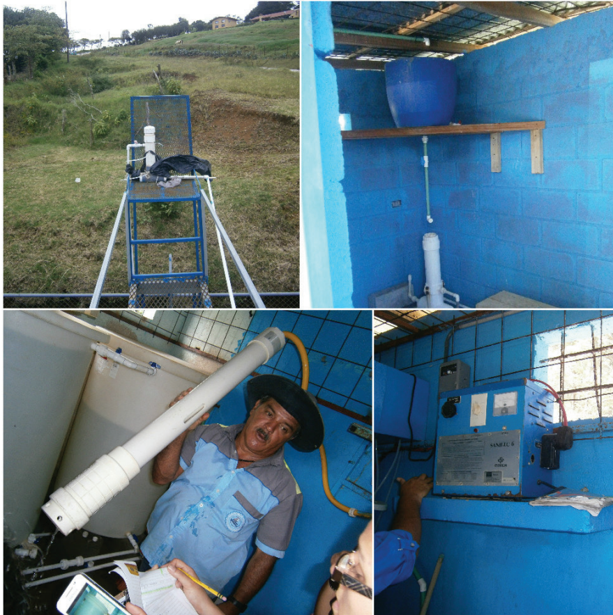
Figura 5.13. Diferentes sistemas de desinfección presentes en los acueductos evaluados Cantón Central.
