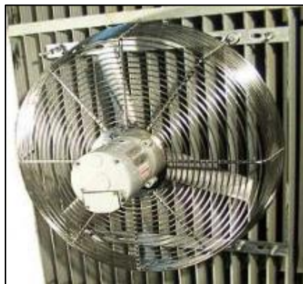
Figura 3.4. Ventilador de enfriamiento de los transformadores.
