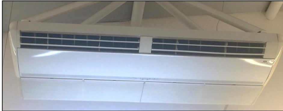
Figura 3.2. Aire acondicionado presente en el cuarto de control.
