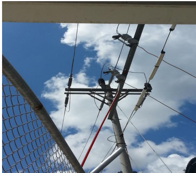
Figura 5.5. Desconexión de fusibles principales en acometida
