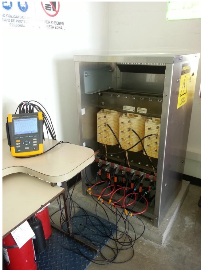
Figura 3.1 Conexión de analizador de energía en transformador de 480/208-120 V
