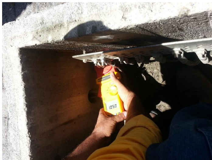
Figura 5.20 Medición de la resistencia a tierra de un electrodo
