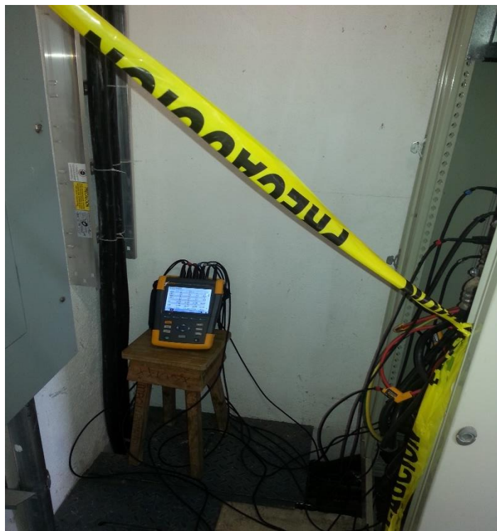
Figura 3.3 Equipo durante medición en Tablero General de Toma de Aguas (TGTA)
