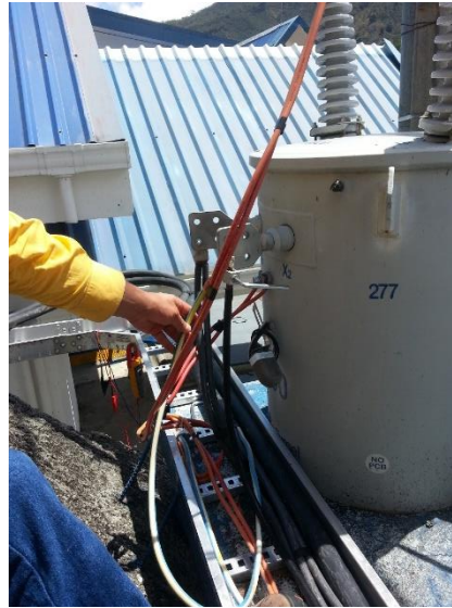
Figura 5.6. Cable de puesta a tierra de neutro desconectado.
