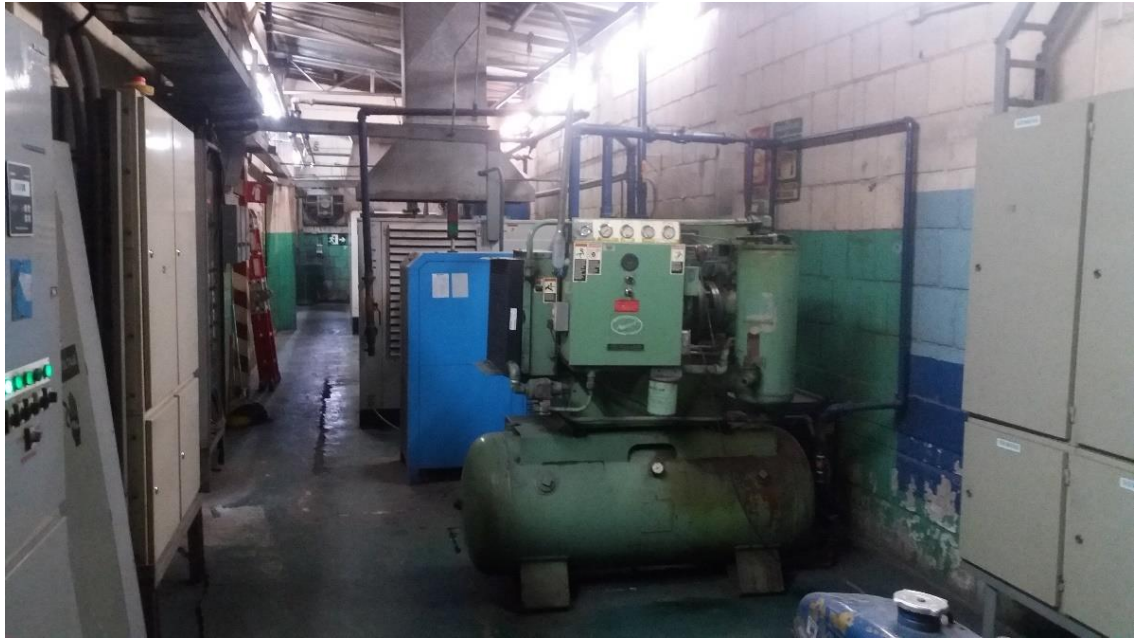
Figura 4.6 Cuarto de máquinas
