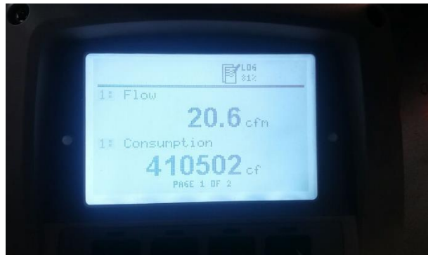
Figura 4.58 Medición de fugas en la instalación de aire comprimido
