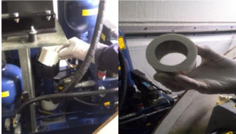
Figura A4.2 Verificación Estado Filtros de Aire
