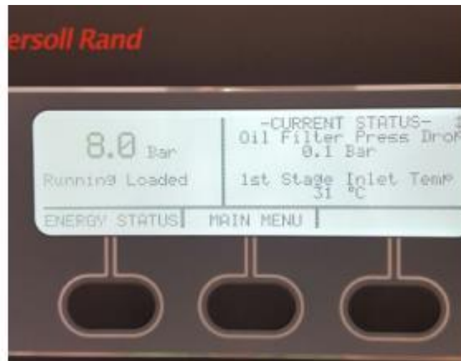
Figura 4.7 Estado del filtro de aceite y temperatura de entrada del compresor Fuente: J. González (2017)
