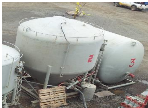
Figura 0.6. Tanque de almacenamiento de mezcla de cemento. (2015)
