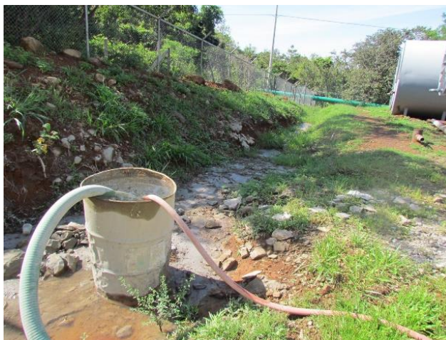
Figura 4.2. Fotografía en departamento de cementación sobre la generación de efluentes con cemento. (2015)
