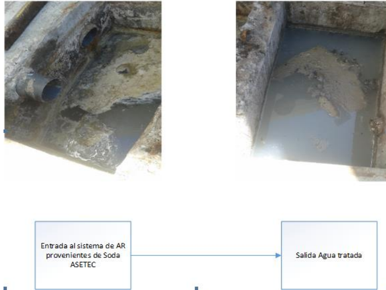
Figura 4. 3. Sistema de tratamiento de la TG de la Soda ASETEC.
