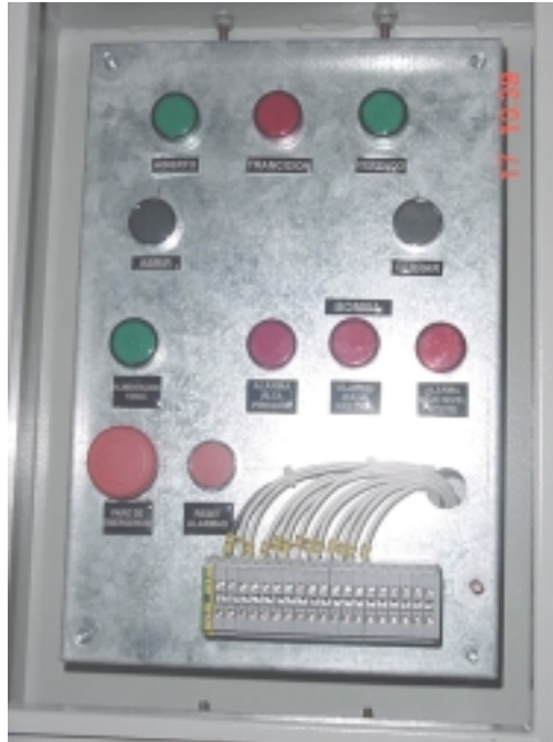
Figura A11. Fotografía del panel de mando del Desarenador Maravilla
