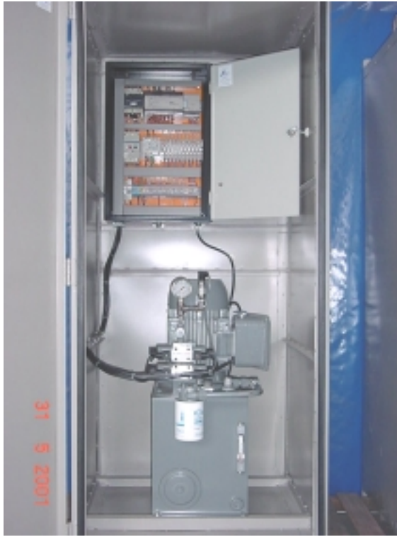
Figura A13. Fotografía del panel de control
