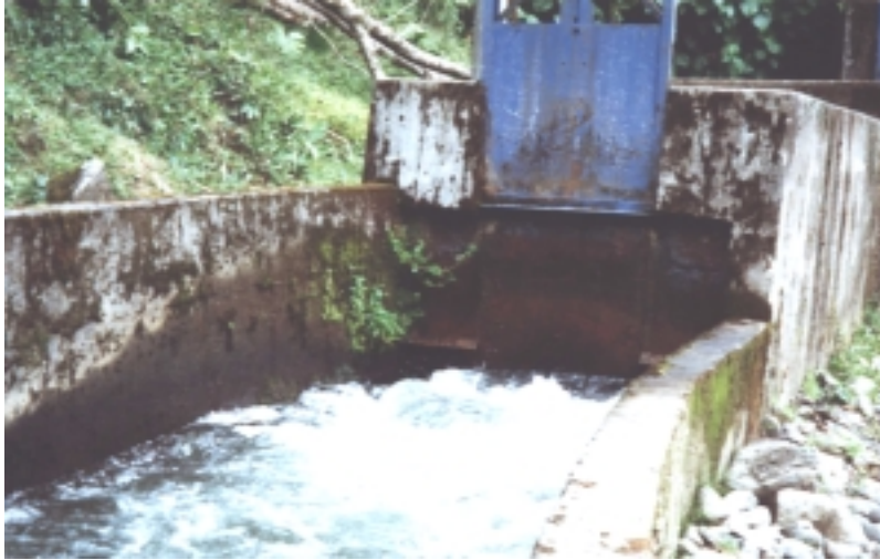
Figura A8. Fotografía de Compuerta Reguladora Maravilla
