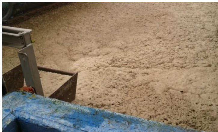
Figura 4. 5. Espuma que cubre los tres tanques de aireación
