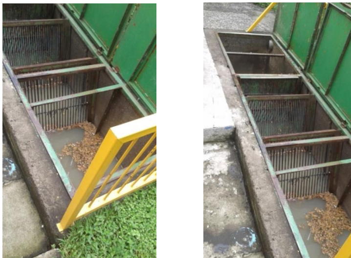
Figura 4. 1. Unidad de pretratamiento de la PTAR de Monserrat, Tres Ríos
