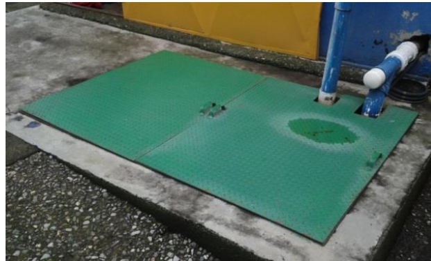
Figura 4. 2. Tanque ecualizador de la PTAR de Monserrat, Tres Ríos
