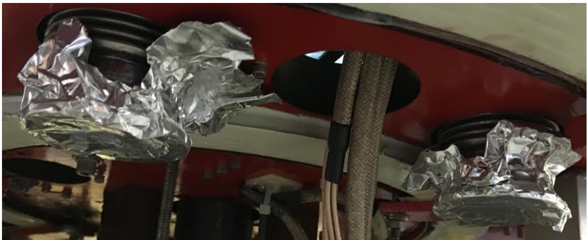
Figura 26. Entradas de bombas de vacío de MEDUSA-CR.
