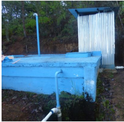
Tanque Heiner y caseta de cloración
