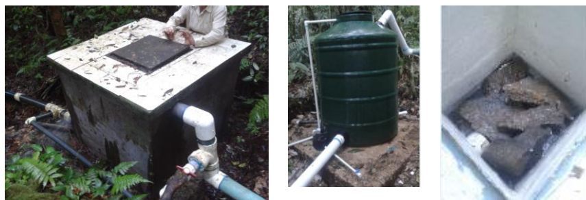
Figura 38. Tanque de filtración con piedra caliza (imagen de la izquierda), tanque plástico (imagen central), actual filtro de piedra caliza (imagen de la derecha)
