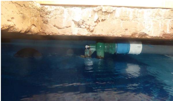
Boya de cierre del caudal de entrada al Tanque.
