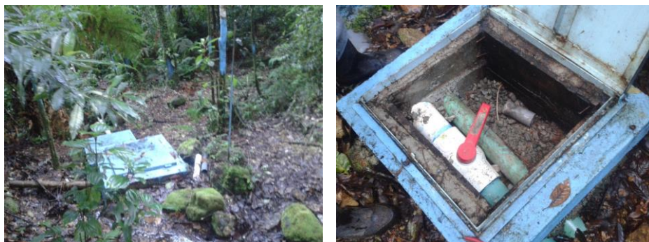
Figura 37. Interior de las cajas de registro en la naciente Los Gamboa N°2
