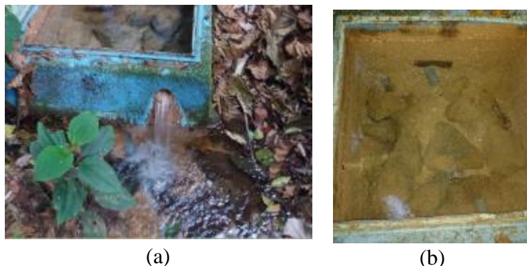
Figura 40. Captación naciente Gildo Mena (a) vista frontal y rebalse de la naciente; (b) interior de la captación
