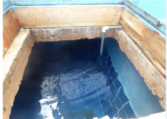
Ingreso del caudal de cloración al Tanque.
