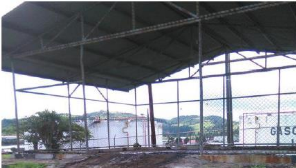
Fotografía 5.1. Instalaciones del centro de acopio del Plantel El Alto de RECOPE S.A.
