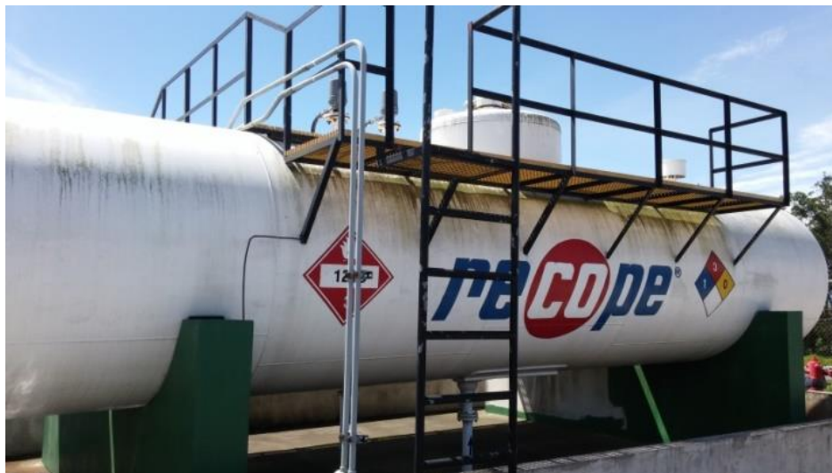
Fotografía 5.3. Tanque de almacenamiento de residuos de hidrocarburos líquidos y lodosos.
