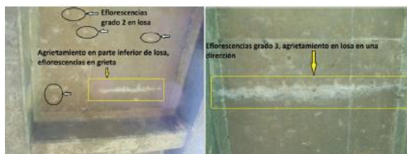
Figura 12: Eflorescencia grado 2 y 3.
