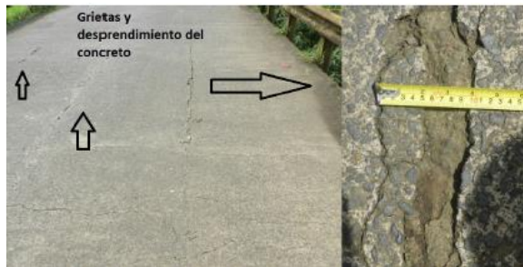
Figura 22: Agrietamiento y descascaramiento.
