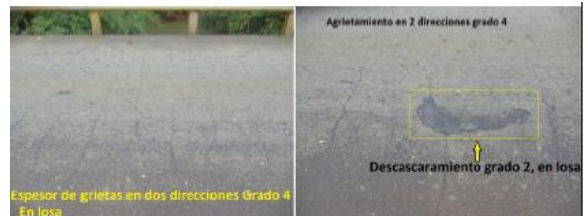
Figura 46: Agrietamiento grado 2 y 4.
