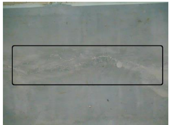
Figura 56: Agrietamiento y eflorescencia.
