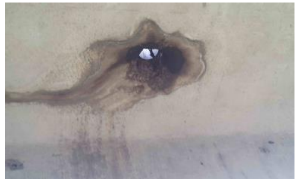
Figura 13: Eflorescencia grado 2 y acero de refuerzo grado 3.
