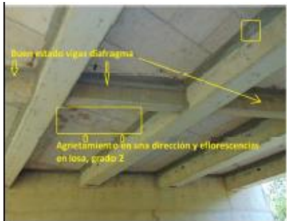
Figura 49: Agrietamiento y eflorescencia.
