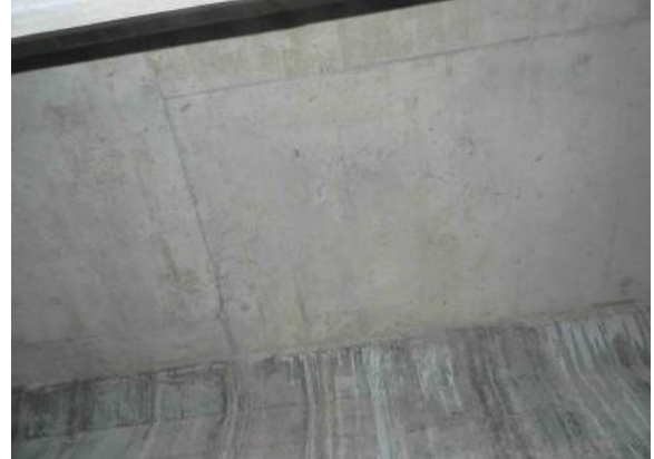
Figura 45: Eflorescencia y Agrietamiento.
