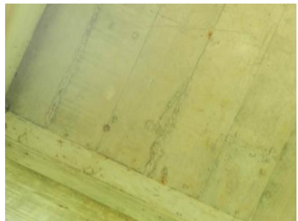
Figura 37: Descascaramiento y eflorescencia.
