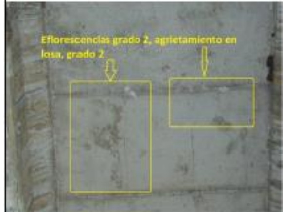
Figura 50: Agrietamiento y Eflorescencia.
