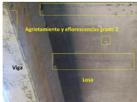
Figura 42: Agrietamiento y eflorescencia.
