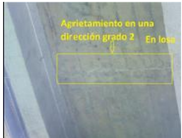
Figura 47: Agrietamiento y Eflorescencia.
