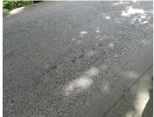
Figura 35: Desgaste de superficie de rodamiento.
