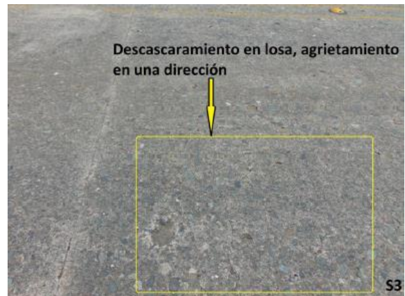
Figura 51: Agrietamiento y descascaramiento.
