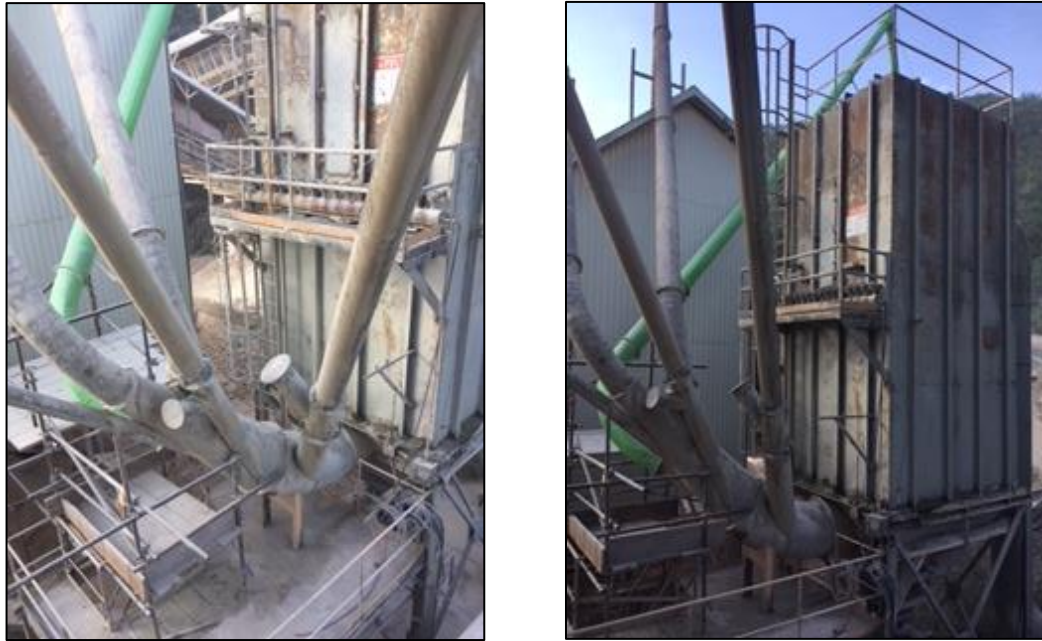
Figura 32. Situación actual de la conexión de tuberías a la entrada del filtro de mangas.
