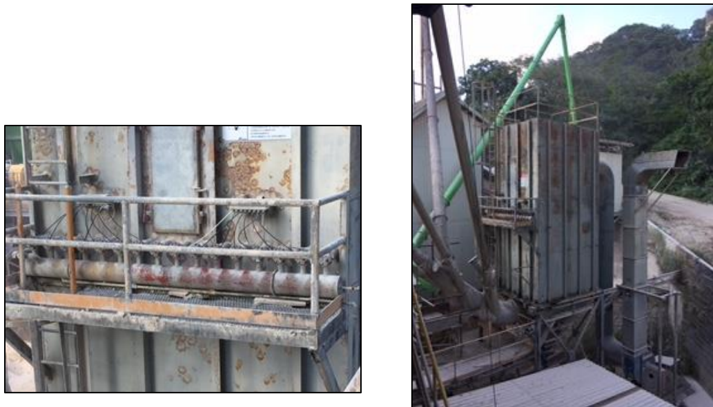
Figura 33. Situación actual del sistema de limpieza por pulsos y estructura del filtro de mangas.
