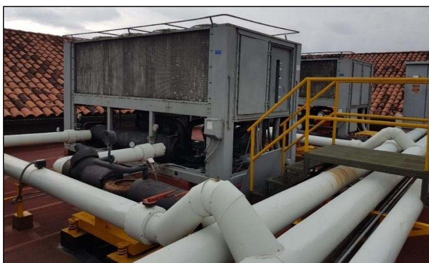
Figura 16. Plantas de agua helada enfriada por aire instalada
