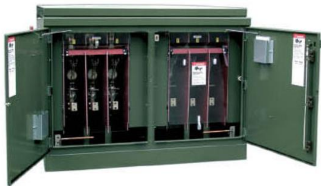
Figura 26. Celda de medición tipo pad mounted de Federal Pacific
