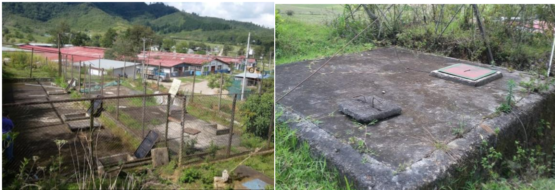
Figura A.1.2 Tanques de almacenamiento de agua del acueducto de CDN
