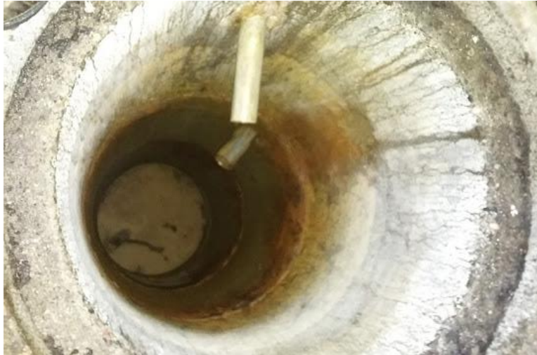
Figura A.1.3 Estado estructural interno del pozo naciente
