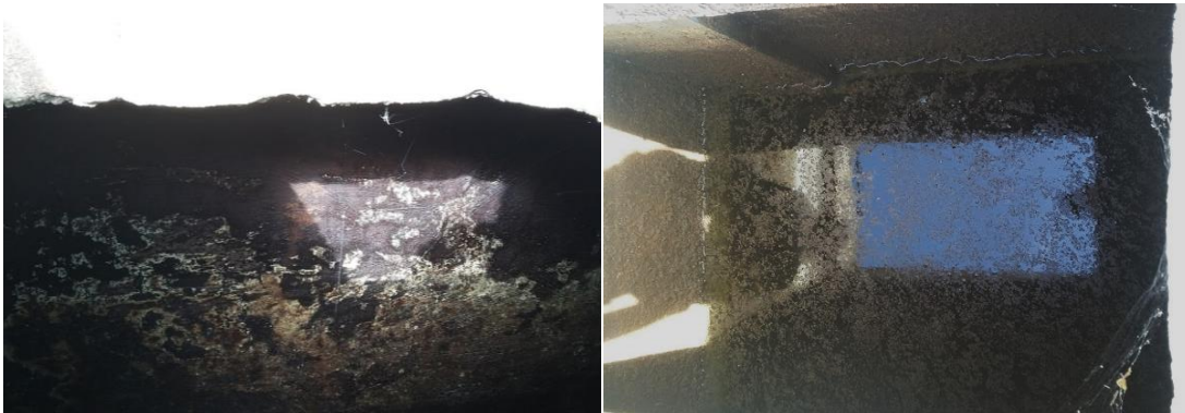
Figura A.1.4 Paredes internas del tanque de almacenamiento principal
