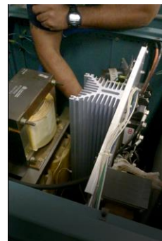
Mantenimiento en regulador eléctrico
