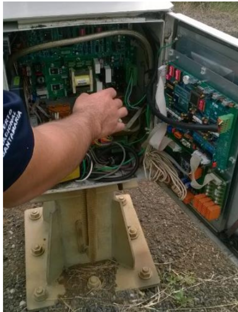
Apéndice 6. Caja eléctrica de una torre ALS
