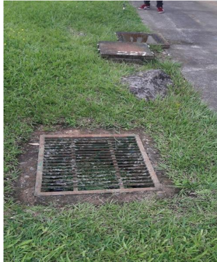
Figura 30. Sistema de Drenaje. Fuente: Grupo de trabajo, (2017).
