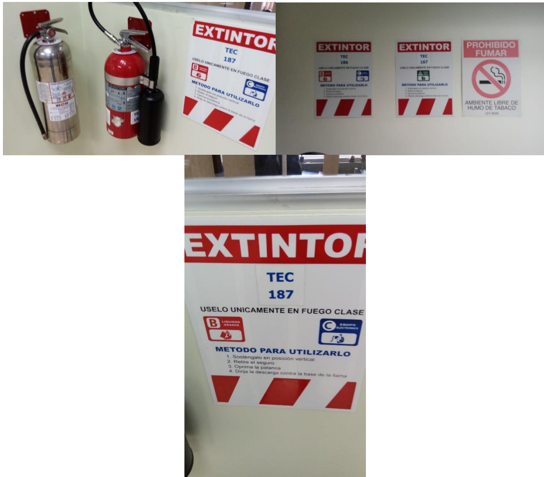
Figura 53. Señalización extintores. Fuente: grupo de trabajo, (2017).
