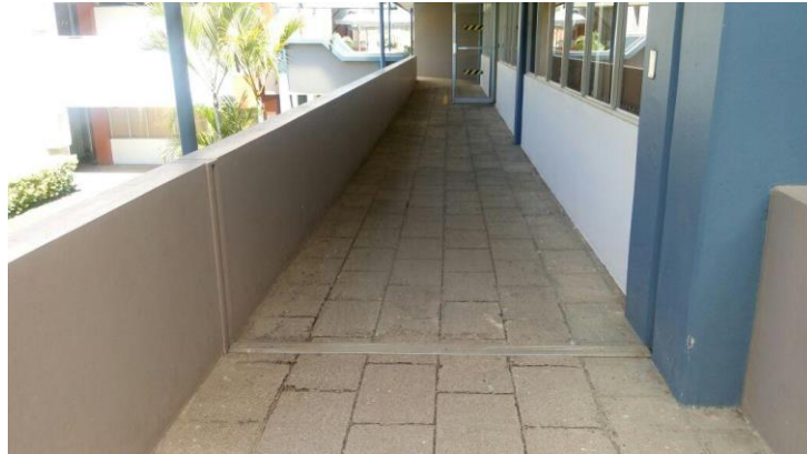
Figura IV-10. Deficiencias en los pasillos. Fuente: El autor.
