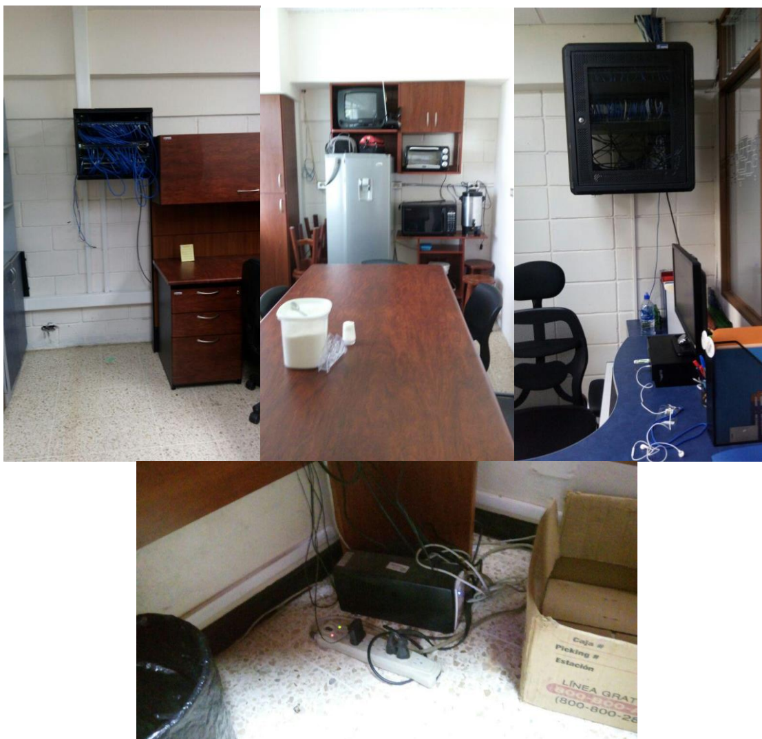
Figura 25. Problemas encontrados con las instalaciones eléctricas. Fuente: Grupo de trabajo, (2017).
