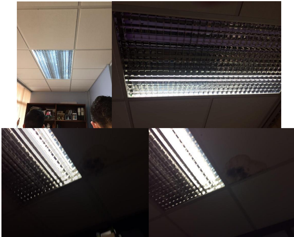
Figura 26. Estado general de la luminaria. Fuente: Grupo de trabajo, (2017).
