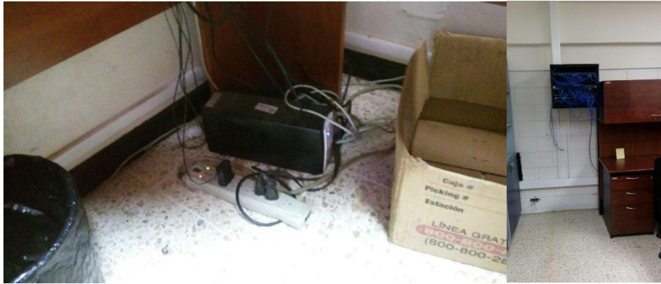
Figura IV-6. Problemas con el cableado. Fuente: El autor.
