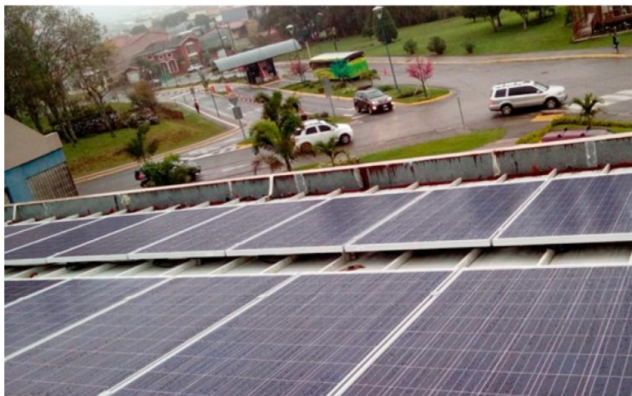
Figura 24. Paneles solares Edificio de Rectoría. Fuente: Hoy en el TEC, (2012).
