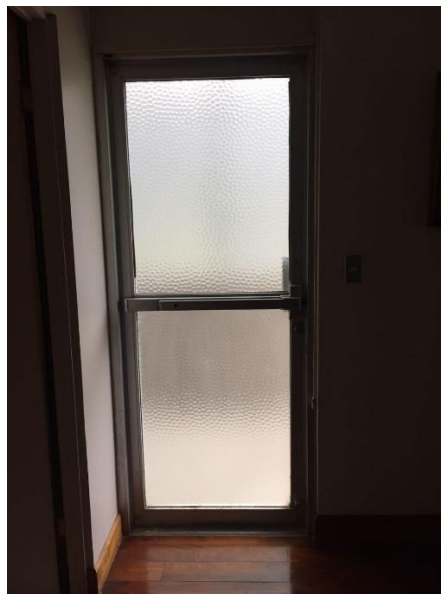
Figura IV-13. Puertas de emergencias cerradas. Fuente: El autor.
