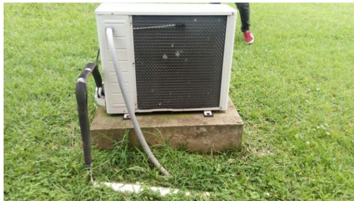
Figura 33. Anclajes aire acondicionado. Fuente: Grupo de trabajo, (2017).
