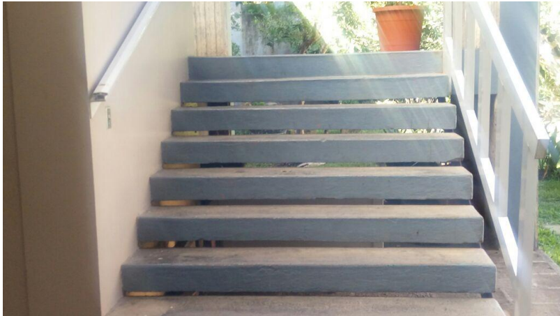
Figura V-13. Escalera con contra huellas que deben cerrarse. Fuente: El autor.
