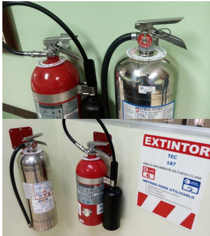
Figura 44. Ejemplos de extintores. Fuente: Grupo de trabajo, (2017).
