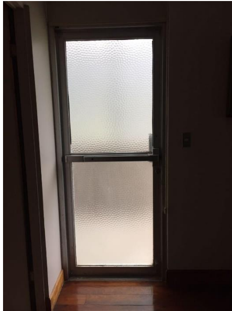
Figura 52. Puerta de emergencia cerrada. Fuente: Grupo de trabajo, (2017).
