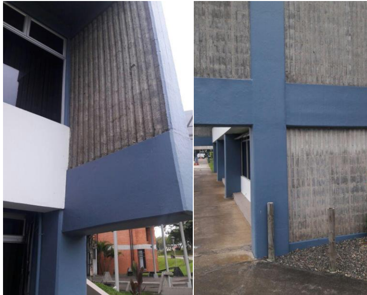
Efecto Viga Fuerte/Columna débil. Fuente: Grupo de trabajo, (2017).
