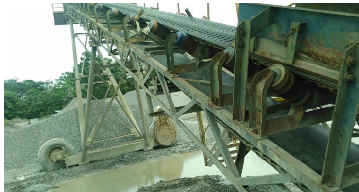
Figura 64. Vista de transportador HGU2.421-BT13.
