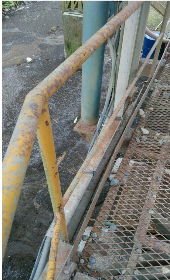
Figura 54. Corrosión en pasarelas, Transportador HGU2.421-BT1.
