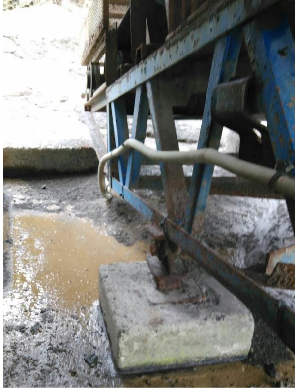
Figura 56. Corrosión en conveyor, transportador HGU2.421-BT2.
