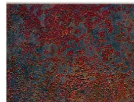
Figura 8. Grado de corrosión B.
