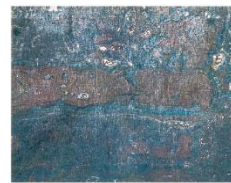
Figura 7. Grado de corrosión A.
