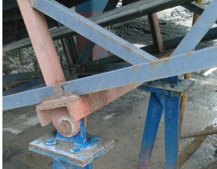
Figura 62. Vista lateral de conveyor, transportador HGU2.421-BT6.
