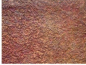
Figura 9. Grado de corrosión C.
