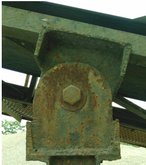
Figura 59. Corrosión en uniones y apoyos, transportador HGU2.421-BT3.
