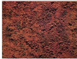
Figura 10. Grado de corrosión D.
