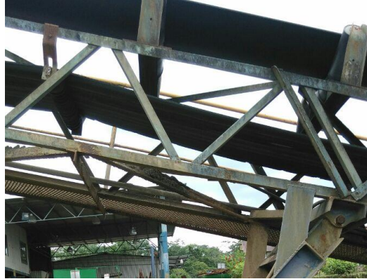
Figura 60. Vista Lateral de conveyor, transportador HGU2.421-BT5.
