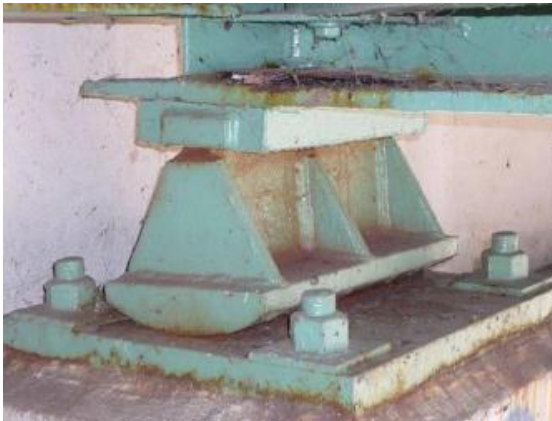
Figura 6. Apoyo Expansivo Tipo Balancín Fuente: Propia. Inspección de puente realizada.
