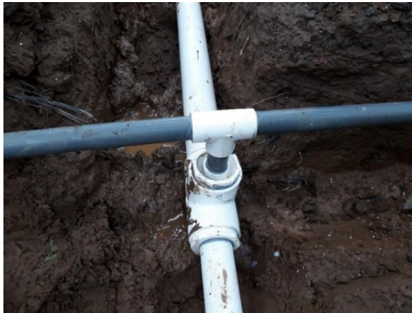
Figura 30. Unión de lateral a la múltiple. Fuente: propia.
