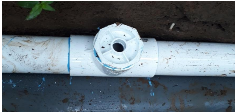
Figura 26. Instalación de tubería y distribución de laterales en 75 mm de diámetro nominal.
