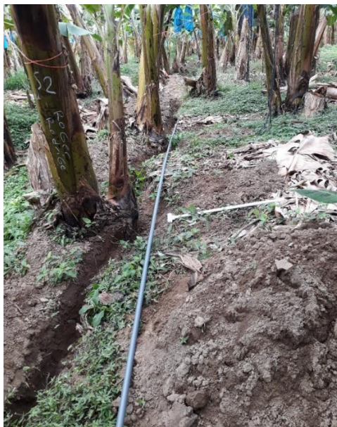
Figura 11. Zanjas mal construidas. Fuente: Propia
