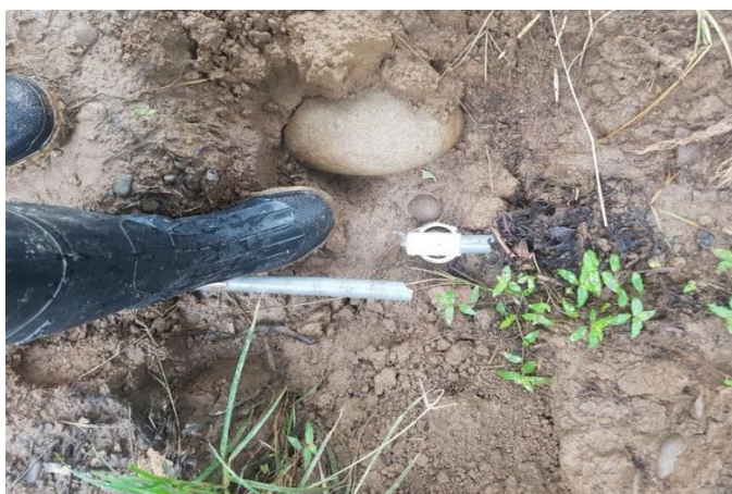
Figura 7. Tubería dañada por el paso de personas.
