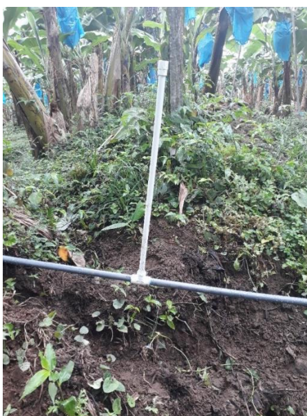
Figura 33. Instalación de elevador sobre el espejo de agua de un canal. Fuente: propia
