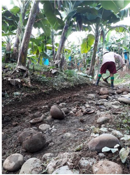
Figura 12. Presencia de piedra en las zanjas. Fuente: Propia
