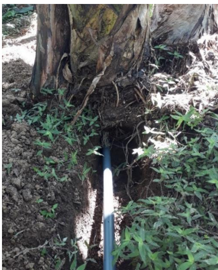
Figura 29. Paso de la tubería por los túneles (debajo de la planta). Fuente: propia.
