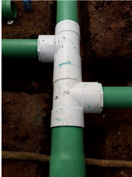
Figura 34. Tubería para la distribución del agua en el área de trabajo. Fuente: propia.
