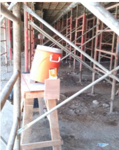
Imagen #7: Hieleras de agua potable.
