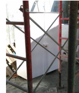
Imagen #8: Armarios para equipo.
